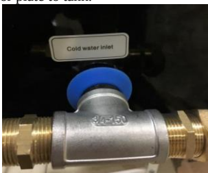
Figure 17: Cold water head on Collector plate. Hình 17: Đầu nước lạnh vào tấm CFP.
